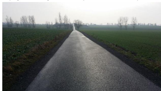
Droga do Kurowa-Wsi po remoncie
