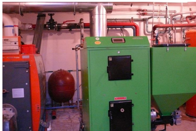
Kotłownia po przebudowie
